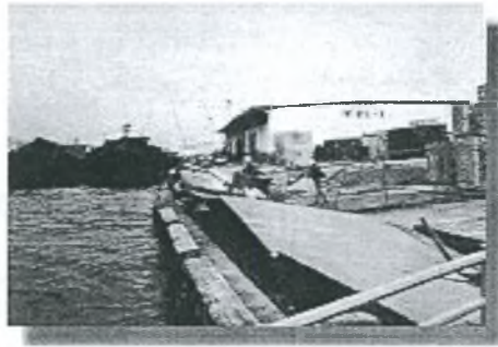
Εικόνα 1.7: Πλευρική μετατόπιση ενός τοίχου αντιστήριξης, Kobe 1995
