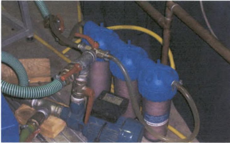
Σχήμα 3-6: Τα φίλτρα τοποθετημένα στο σύστημα της ροής (bypass)
