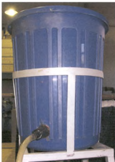
Σχήμα 3-4: Δοχείο τοποθετημένο ψηλά
