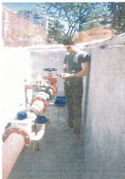
Εικόνα 6.2. Φρεάτιο μειωτή πίεσης στην Πολυτεχνείου [Πηγή : Αρχεία Ε.Υ.Α.Θ.]
