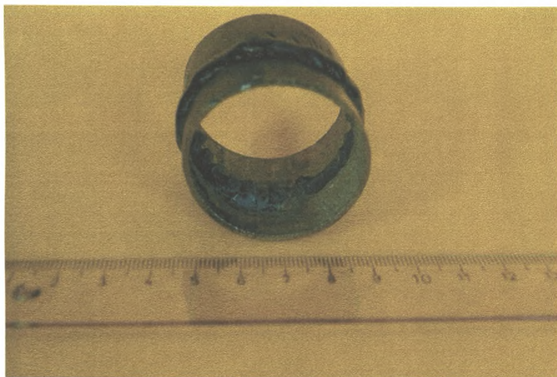
Φώτο 2. Φωτογραφία του εσωτερικού του αγωγού με την συγκόλληση και την ρωγμή όπου φαίνεται η περίσσεια υλικού
