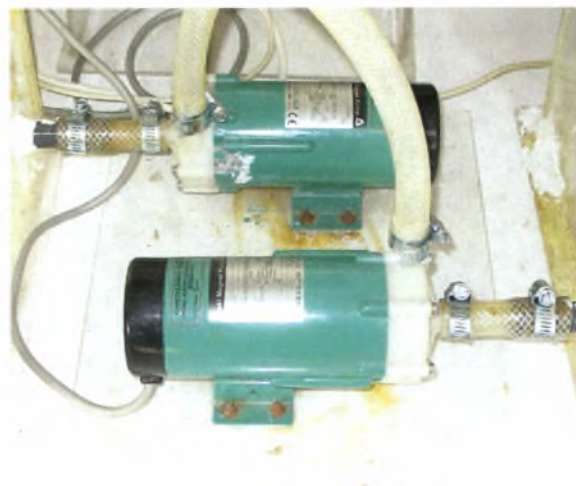
Εικόνα 4.3 β) Αντλίες μεταφοράς
