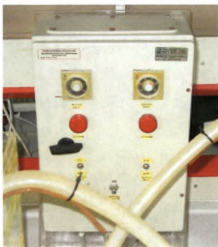
Εικόνα 4.3 α) Ηλεκτρολογικός πίνακας διαλύματος
