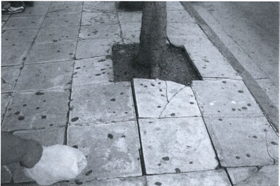
Φ.5.1. Έντονα σπασίματα στο πεζοδρόμιο δεξιά της στάσης
