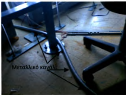
Εικ.[5.1] Θωράκιση καλωδίου τροφοδοσίας κινητήρα
