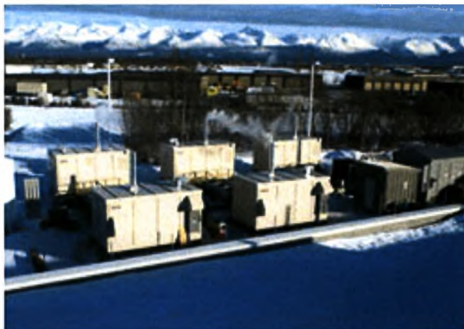
Σχήμα 2.26. Πρότυπη μονάδα παραγωγής ισχύος, PC25, στη Νέα Υόρκη [27].
