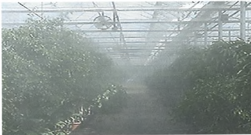
Εικόνα 6. Σύστημα δροσισμού με τεχνητή ομίχλη.
