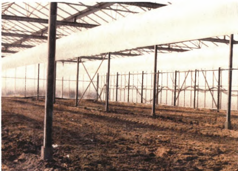
Σχήμα 1.12. Διαφανείς πλαστικοί αεραγωγοί κατανομής του αέρα του αερόθερμου στο χώρο του θερμοκηπίου.
