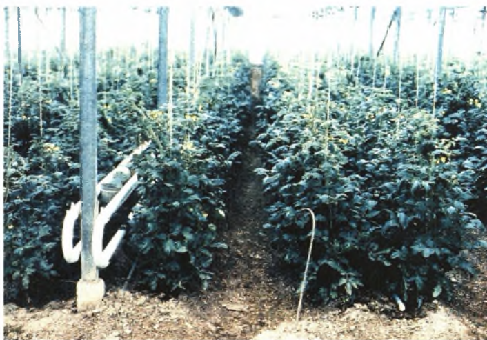
Σχήμα 1.9. Σωλήνες κατανομής της θερμότητας στο χώρο του θερμοκηπίου, τοποθετημένοι κατά μήκος της σειράς των στύλων (κλασικό σύστημα).
