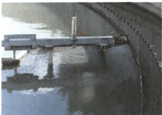
Εικόνα 3 Μηχανισμός αφαίρεση των ουσιών που επιπλέουν (B6)
