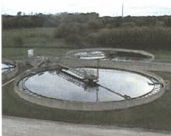
Εικόνα 2 Δεξαμενές καθιζήσεως (B5)
