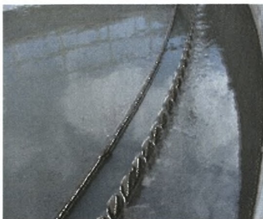
Εικόνα 4 Υπερχείλιση του καθαρού υγρού για περαιτέρω επεξεργασία (B6)
