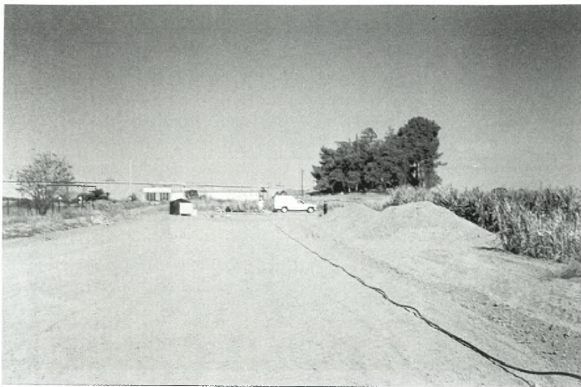
Εικόνα 10. Εκσκαφή του αγρού σε βάθος 15 εκ. με τη βοήθεια εσκαφέα όπου την ακολούθησε η ισοπέδωση του αγρού.
