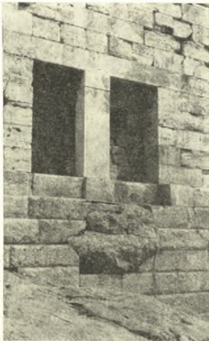
Εἰκ. 15. Ὁρθογώνια ἀνοίγματα ἐπὶ τῆς δυτικῆς πλευρᾶς τῆς κλασσικῆς ἐπενδύσεως τοῦ πύργου.
