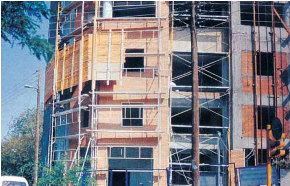
Εικόνα 8: Εργασίες οικοδομικού έργου δίπλα σε δίκτυο της Δ.Ε.Η. (Πηγή: https://xigakis.gr/ )
