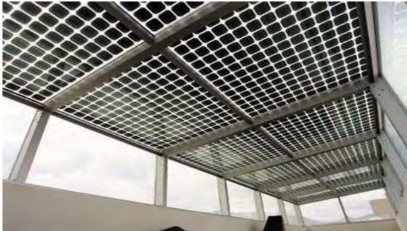
Εικόνα 8. Ενσωματωμένα Φ/Β σε Αίθρια και Ανοίγματα Οροφής, Πηγή: https://bit.ly/2SzCIjS
