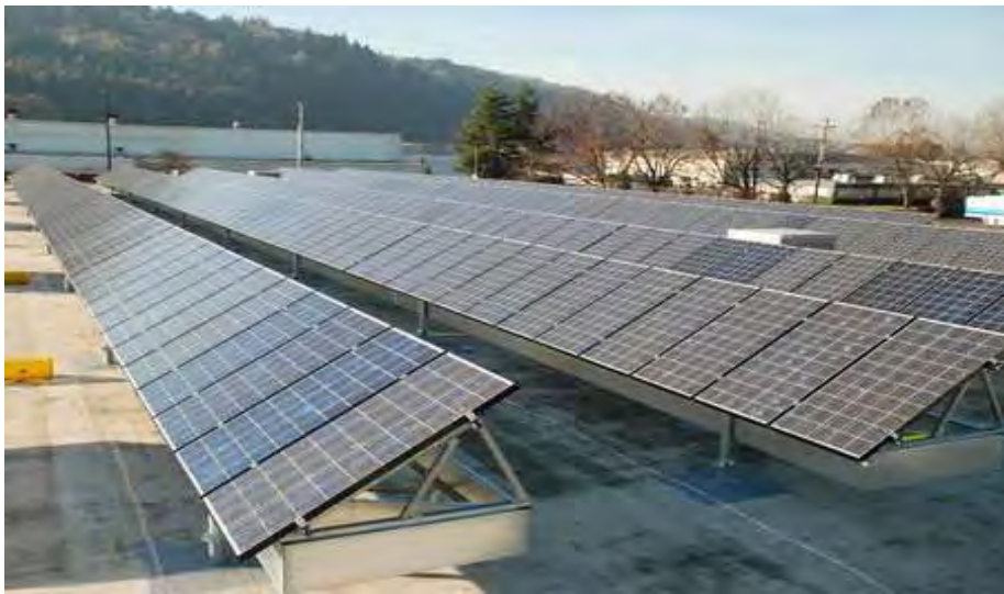
Εικόνα 5. Μη Ενσωματωμένα Φ/Β σε Δώμα, Πηγή: https://bit.ly/2EuXZGb
