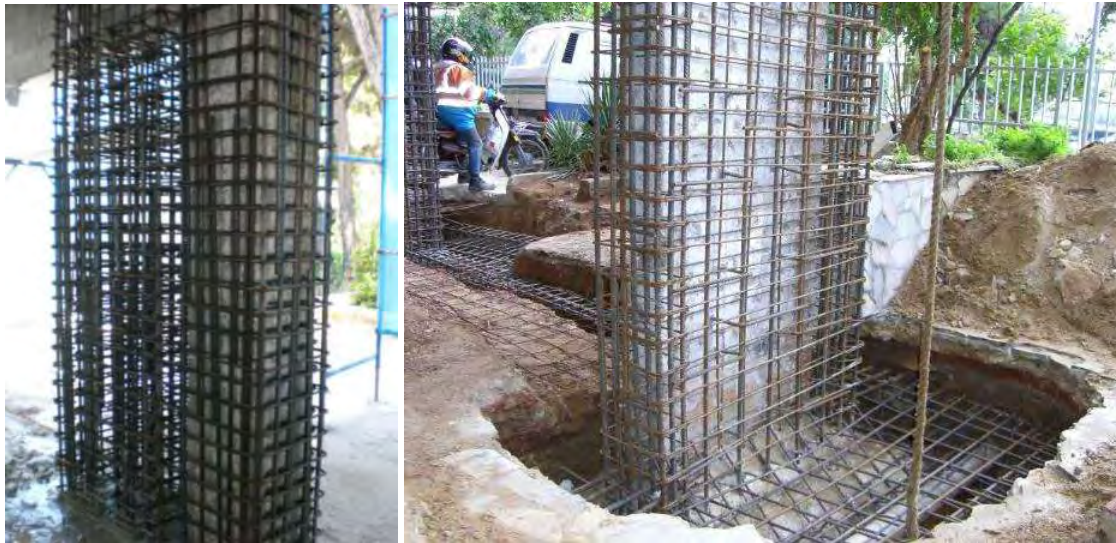
Σχήμα 2.2 : Αριστερά : Ενίσχυση υποστυλώματος με μανδύα οπλισμένου σκυροδέματος (μετατροπή υποστυλώματος σε τοίχιο), Δεξιά : Ενίσχυση τοιχείου με μανδύα οπλισμένου σκυροδέματος[6].
