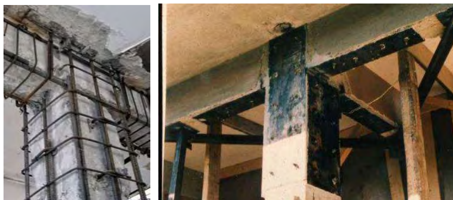
Σχήμα 1.10 : Αριστερά ενίσχυση κόμβου με μανδύα οπλισμού και εκτοξευόμενο σκυρόδεμα, δεξιά ενίσχυση κόμβου με κολλάρα, μεταλλικά ελάσματα και κοχλίες[12],[11].
