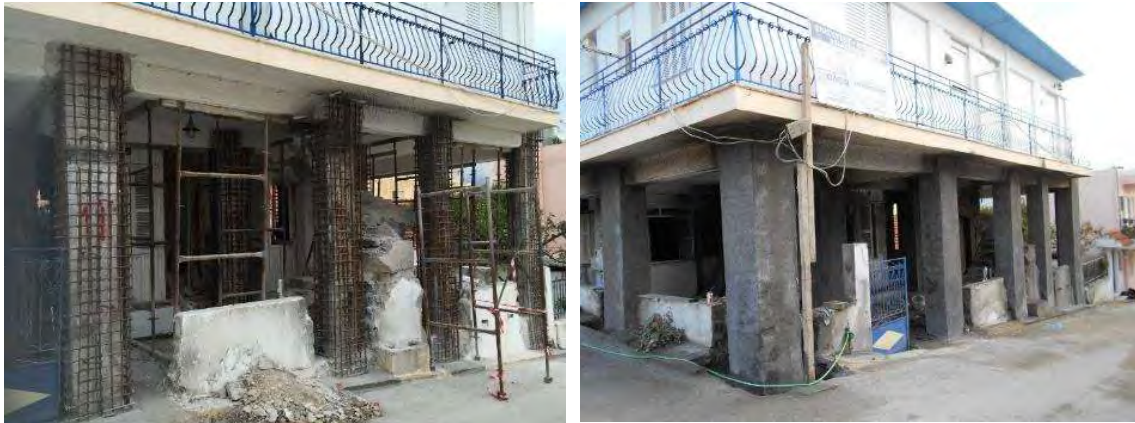
Σχήμα 2.3 : Ενίσχυση υποστυλωμάτων μονόροφης οικοδομής στο σύνολό τους. Αριστερά : τοποθέτηση μανδύα οπλ. Σκυροδέματος. Δεξιά : όψη των υποστυλωμάτων μετά την αποκατάσταση [27].
