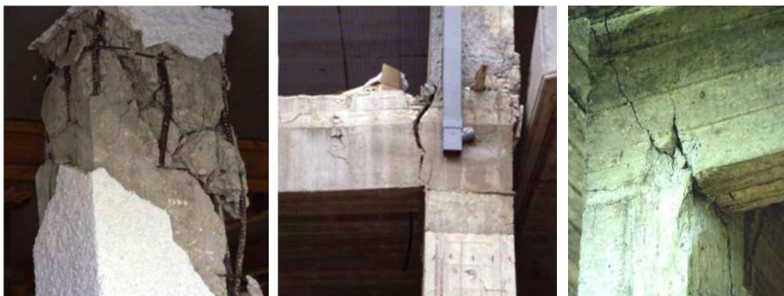
Σχήμα 1.8 : Αστοχίες κόμβων. Αριστερά διατμητική αστοχία λόγω αραιών και λεπτών συνδετήρων στο υποστύλωμα. Κέντρο αστοχία λόγω ανεπαρκούς αγκύρωσης. Δεξιά διατμητική αστοχία στη συμβολή δοκού υποστυλώματος [5]
