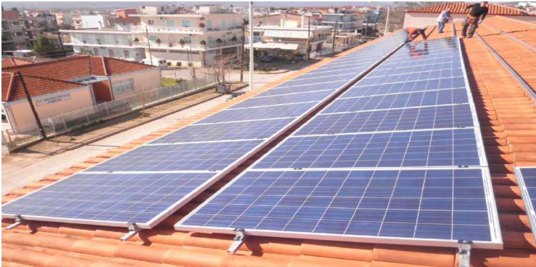
Εικόνα 36: Φωτοβολταϊκά σε στέγη κτιρίου
