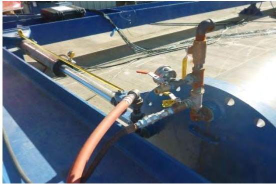
Εικόνα 3. 9: Υποδοχή εισαγωγής ύδατος υπό πίεση.
