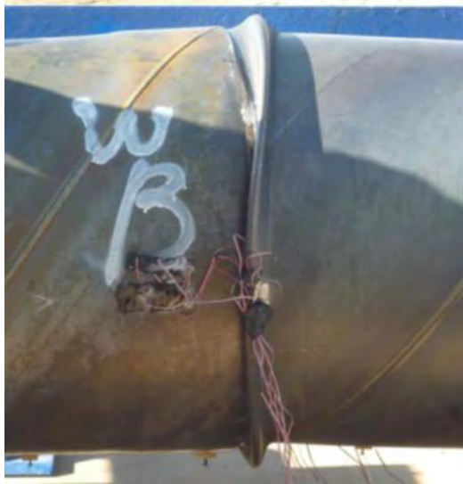
Εικόνα 3. 22: Μορφή αστοχίας δεύτερου δοκίμιου ( D/t=191 , μονή εξωτερική συγκόλληση).
