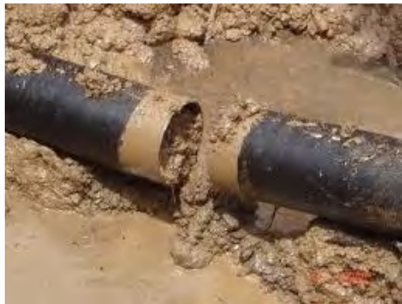
Εικόνα 1. 3: Περίπτωση αστοχίας χερσαίου αγωγού.
