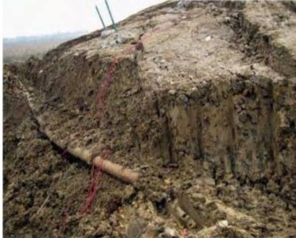
Εικόνα 1. 2: Αστοχία αγωγού λόγω καθίζησης.
