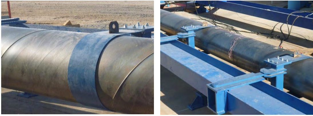
Εικόνα 3. 7: Μεταλλικές στηρίξεις (staps).
