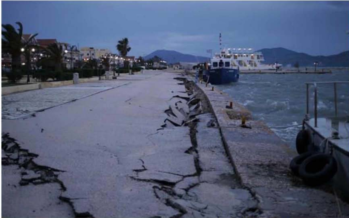
Εικόνα 4.8 - Ρήγμα στο λιμάνι του Ληξουρίου ( www.naftemporiki.gr )
