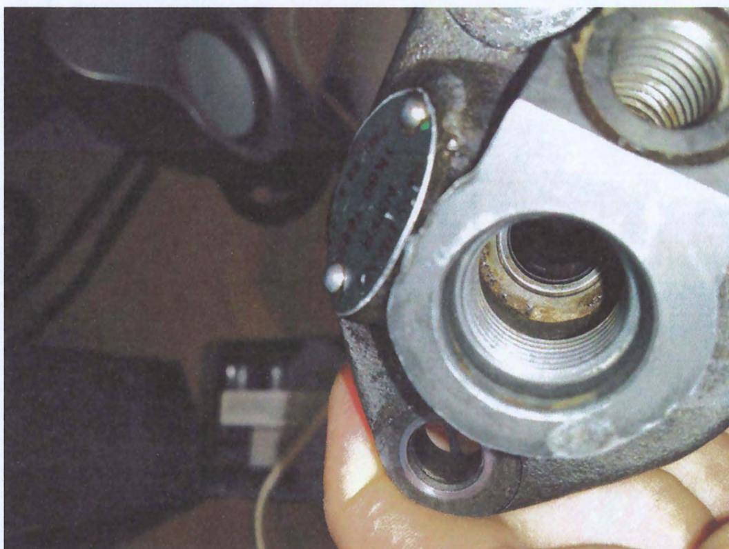
Εικόνα 20: Επικαθίσεις στο εσωτερικό σώμα της αντλίας πετρελαίου
