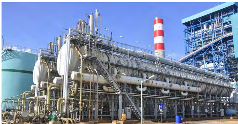
Εικόνα 2.3: Μονάδα αφαλάτωσης με χρήση της τεχνολογίας (MED)
