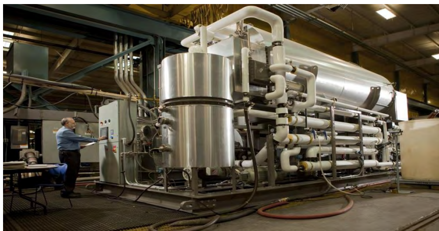
Εικόνα 2.4: Εγκατάσταση αφαλάτωσης με την μέθοδο της απόσταξης με συμπίεση ατμών με δυνατότητα παραγωγής πόσιμου νερού 6000 gallons / ώρα
