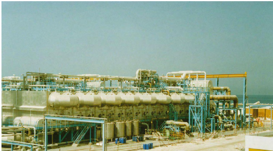
Εικόνα 2.2: Μονάδα αφαλάτωσης με χρήση της τεχνολογίας (MSF) στο Ντουμπάι
