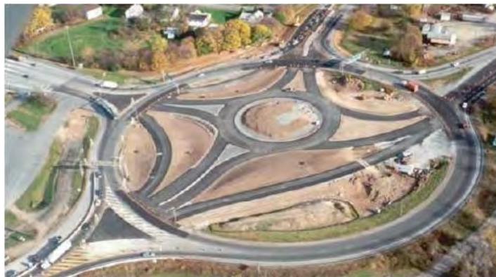
Εικόνα 2.5 Κατασκευή νέου κυκλικού κόμβου εντός παλαιότερης περιστροφικής κυκλοφοριακής διαμόρφωσης - Kingston, New York (NCHRP, 2010)
