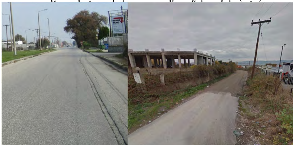
Εικόνα 1.3.6.2: Κατακερατισμένος δρόμος από την τοποθέτηση δικτύων (αριστερά) και κακής ποιότητας οδόστρωμα που καταλήγει σε χωματόδρομο (δεξιά)
