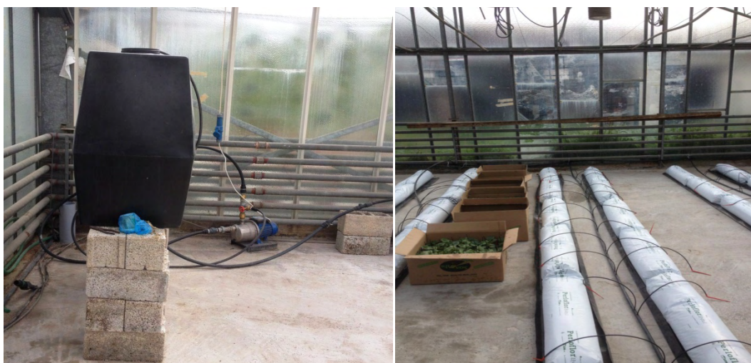
Εικόνα 2.3 Δεξαμενή, αντλία νερού, σωληνώσεις πολυαιθυλενίου, σταλάκτες
