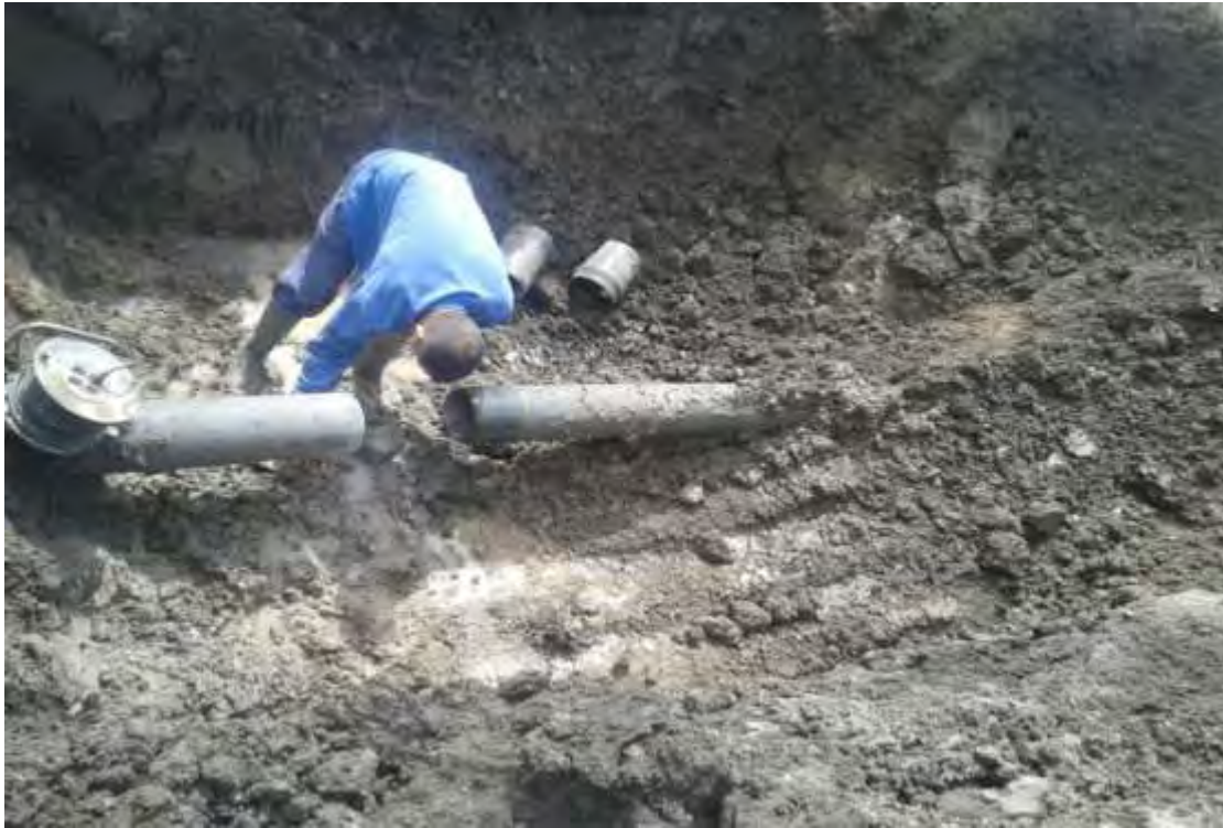
Εικόνα 5.19 βλαβη 7η διαρρηξη αγωγου στη ζώνη Σ2
