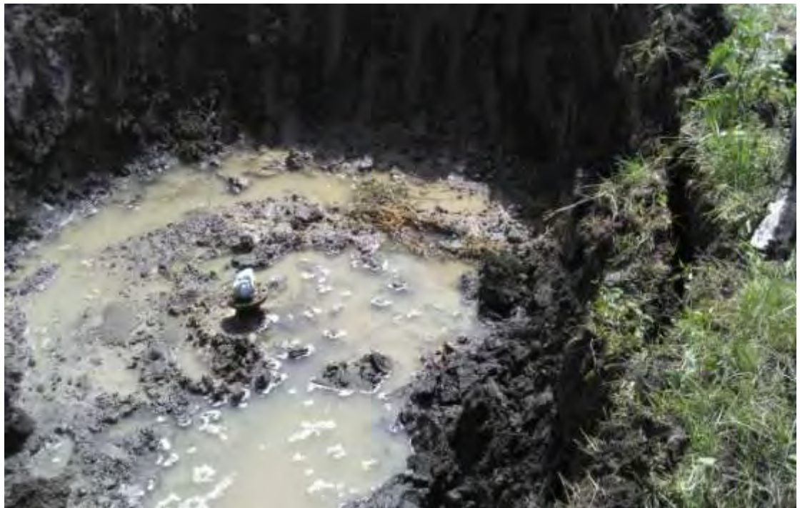
Εικόνα 5.37 βλάβη 11η διάρρηξη αγωγού στη ζώνη Σ4
