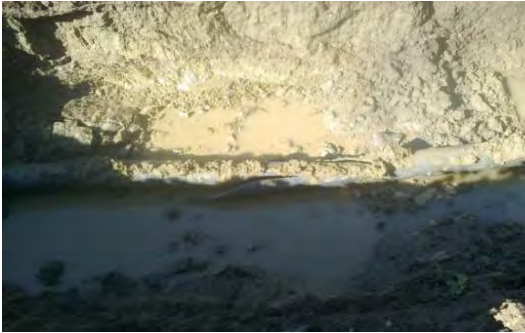
Εικόνα 5.11 βλαβη 11η διαρρηξη αγωγου στη ζώνη Σ3
