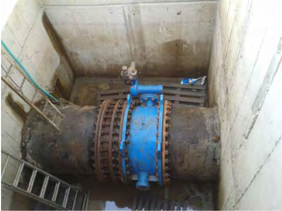
Εικόνα 5.24 βλαβη 12η φθορα ελαστικού παρεμβύσματος στον φ1600 αγωγό στη ζώνη Σ3
