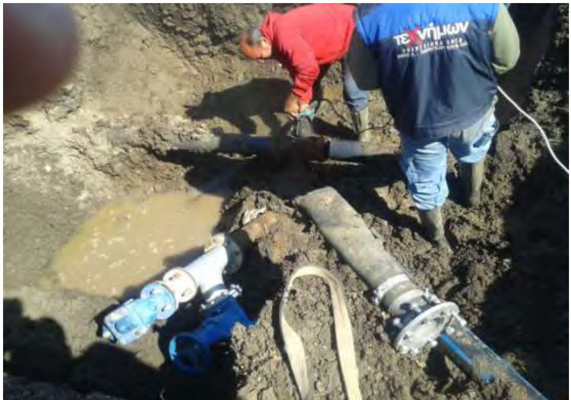
Εικόνα 5.27 βλαβη 1η διάρρηξη αγωγού στη ζώνη Σ4
