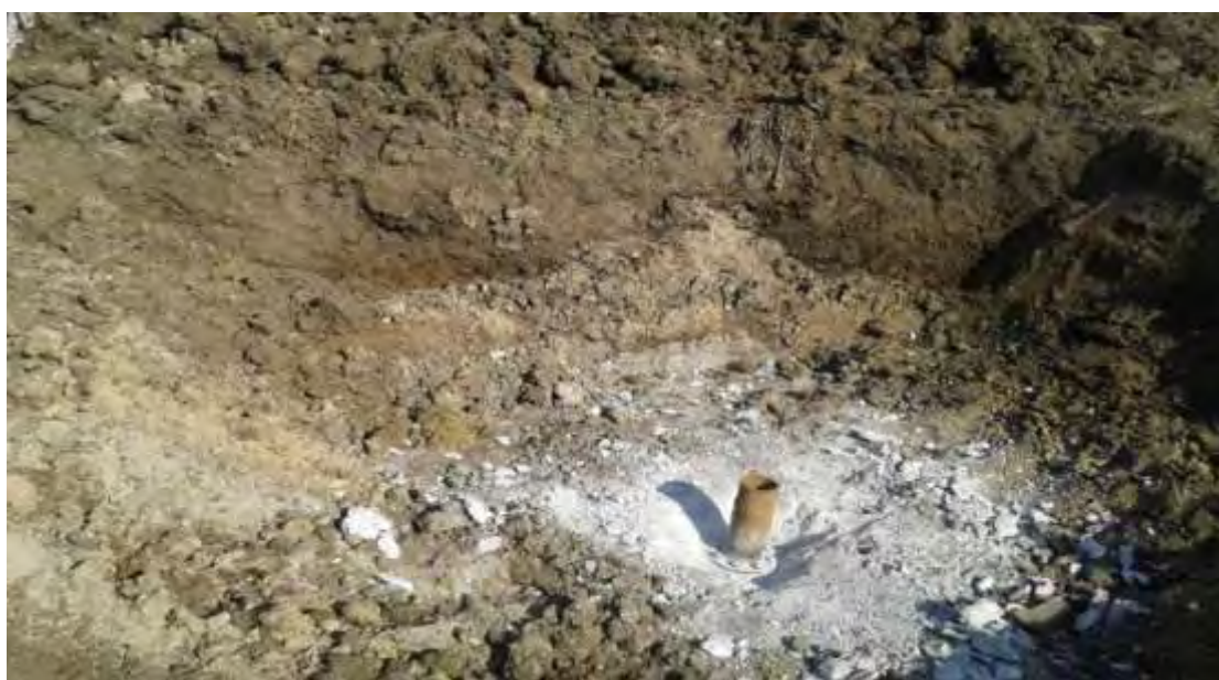
Εικόνα 5.17 βλαβη 5η διαρρηξη αγωγου στη ζώνη Σ2
