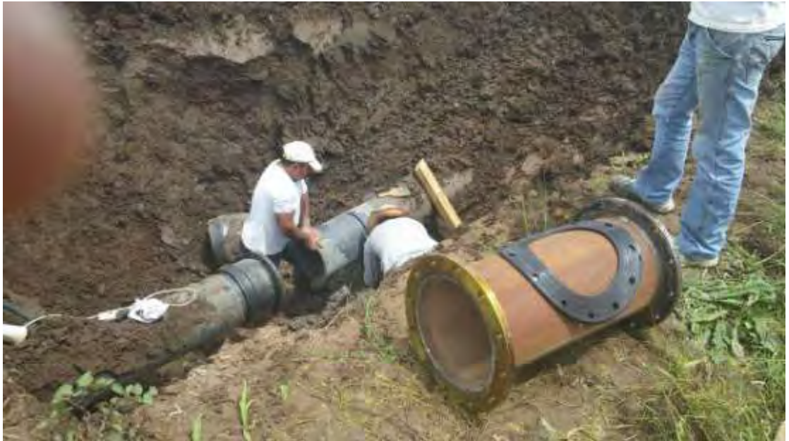
Εικόνα 5.35 βλάβη 9η διάρρηξη αγωγού στη ζώνη Σ4
