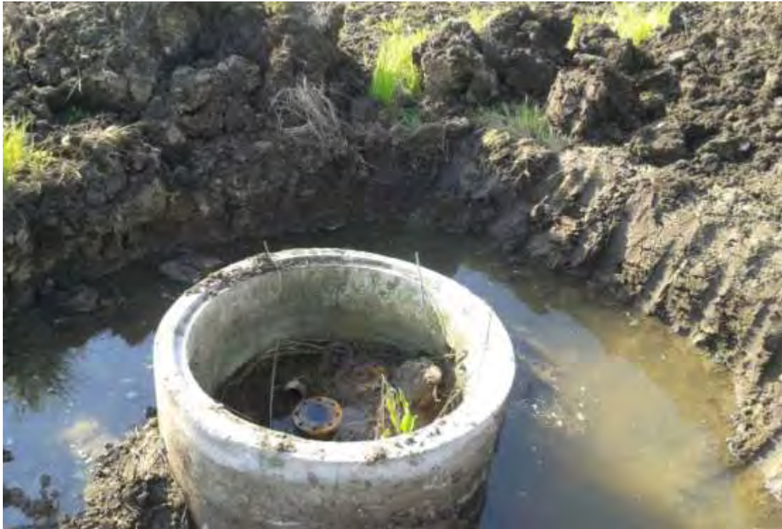
Εικόνα 5.14 βλαβη 2η διαρρηξη αγωγου στη ζώνη Σ4
