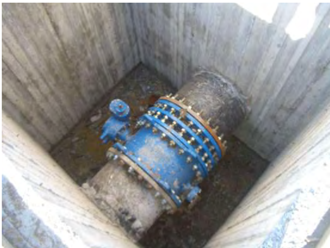
Εικόνα 4.2: Φρεάτιο κλειστού αγωγού Σ2
