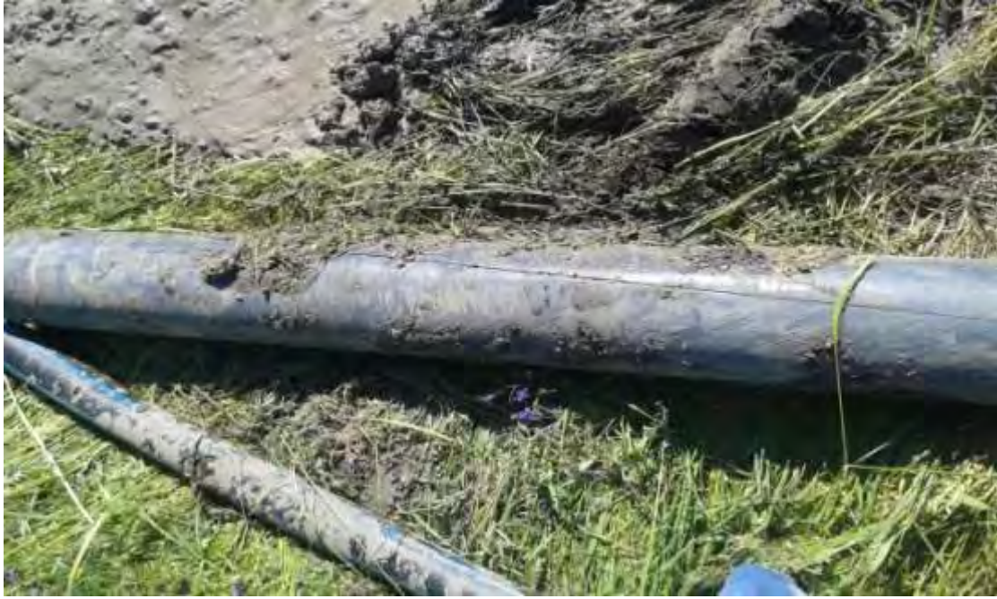
Εικόνα 5.4 βλαβη 4η διαρρυξη αγωγού στη ζώνη Σ2
