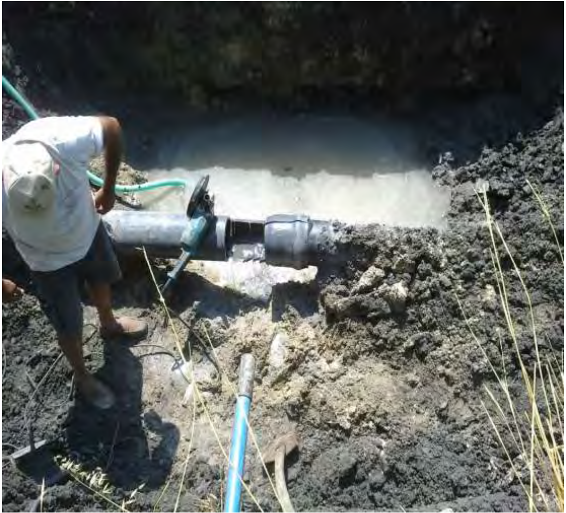
Εικόνα 5.12 βλαβη 12η διαρρηξη αγωγου στη ζώνη Σ3
