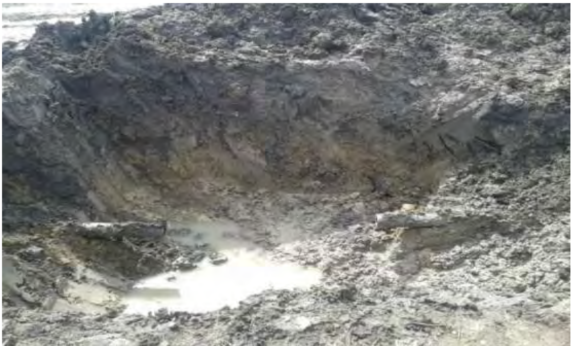
Εικόνα 5.34 βλάβη 8η διάρρηξη αγωγού στη ζώνη Σ2
