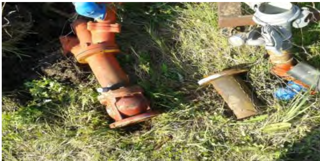
Εικόνα 5.16 βλαβη 4η διαρρηξη αγωγου στη ζώνη Σ2
