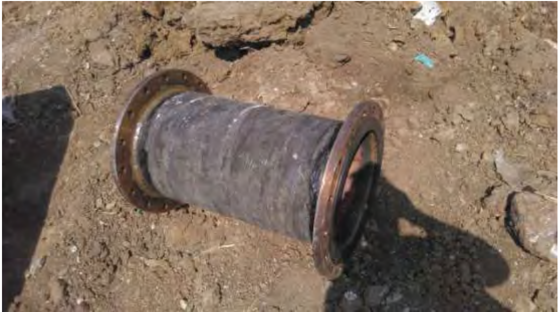
Εικόνα 5.33 βλάβη 7η διάρρηξη αγωγού στη ζώνη Σ4
