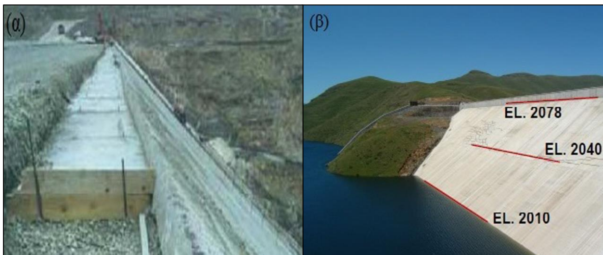
Σχήμα 6.10. (α) Η δοκός σκυροδέματος στη στάθμη 2040 m και (β) Οριζόντιες ρηγματώσεις της πλάκας σκυροδέματος στη στάθμη 2040 m όταν ο ταμιευτήρας έφτασε στη στάθμη 2010 m, περίπου τον Ιανουάριο του 2003 (Johannesson and Tohlang, 2007).
