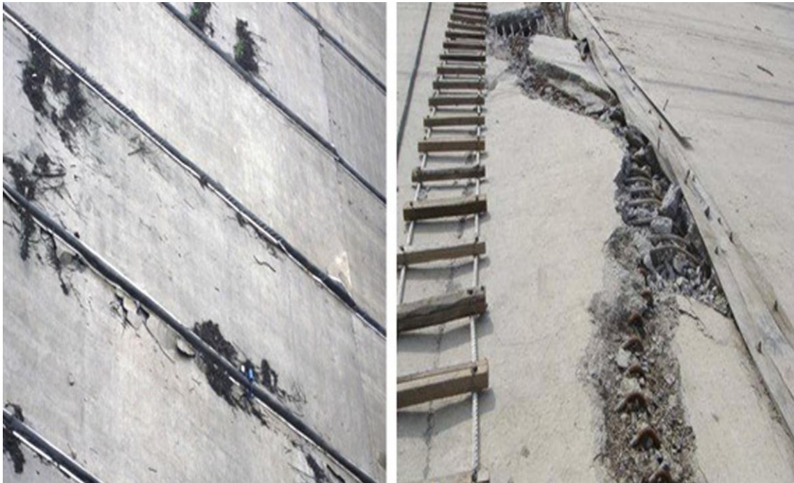
Σχήμα 5.27. Θλιπτική αστοχία των κατακόρυφων αρμών της ανάντη πλάκας του φράγματος Zipingpu, ύψους 156 m κατά τον σεισμό Wenchuan (M=8) της 12-05-2008 (Wieland, 2009, 2008).
