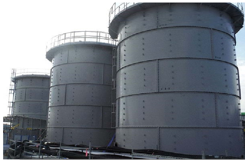
Εικόνα 8.1. 2 Δεξαμενές πετρελαίου με οριζόντιους δακτυλίους στην Φουκουσίμα
