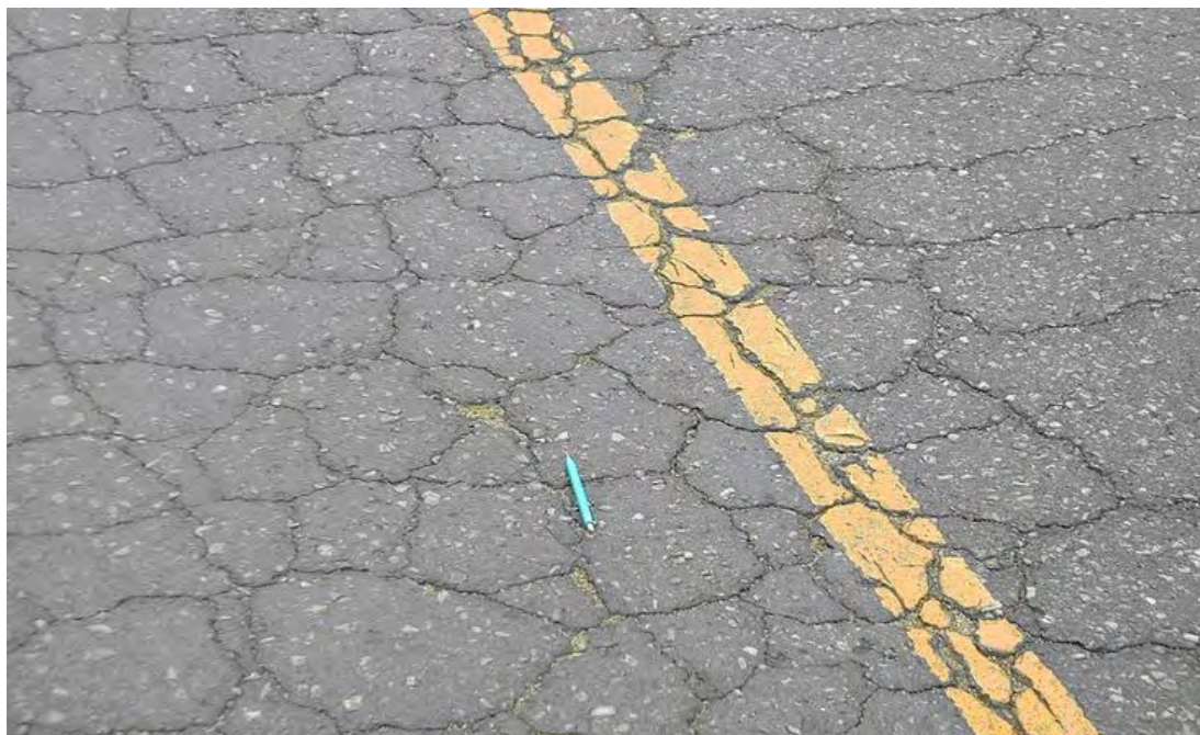
Εικόνα 3.3: Ρωγμές τύπου αλιγάτορα (Πηγή: διαδίκτυο)
