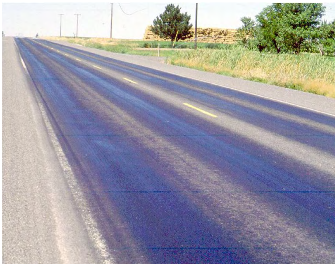
Εικόνα 3.4: Ανάδυση ασφάλτου (Πηγή: διαδίκτυο)
