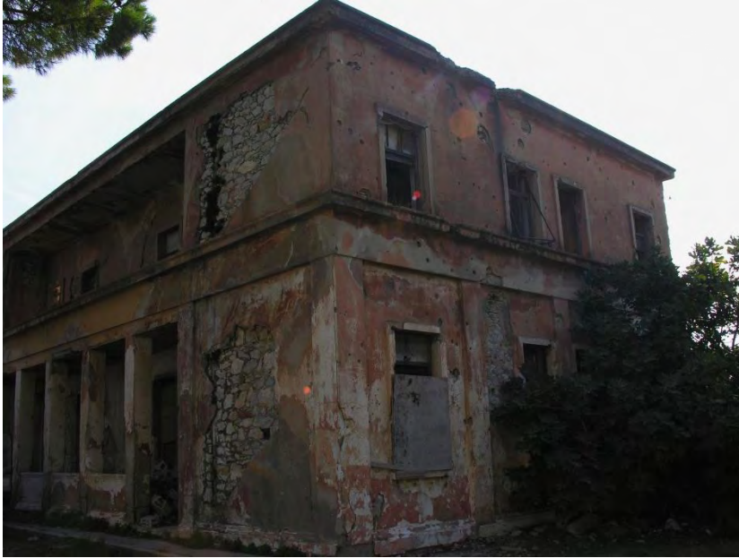
Εικόνα 15_ Ιταλική κατοικία σε ερειπιώδη κατάσταση
