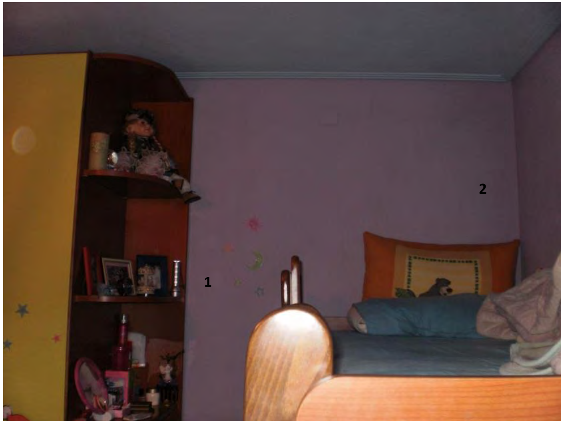
Εικόνα 97: Φωτογραφία του δυτικού τοίχου της παιδικής κρεβατοκάμαρας όπου έχουν επισημανθεί δυο ρωγμές.
