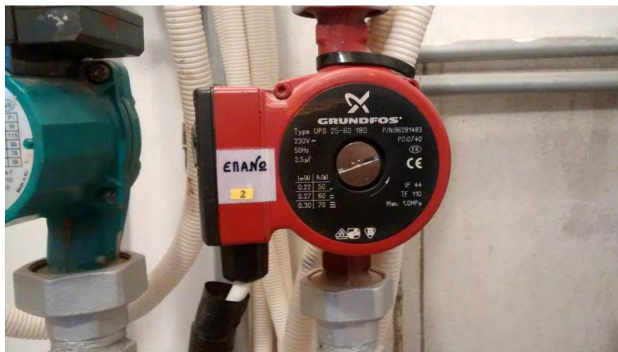
Εικόνα 49: Φωτογραφία της αντλίας του 1 ου ορόφου.
