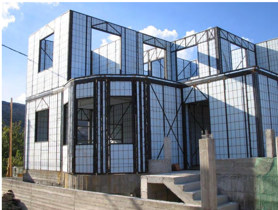
Εικόνα 41: Φωτογραφία της οικίας στο στάδιο της κατασκευής. Διακρίνονται ο μεταλλικός σκελετός και η μόνωση της τοιχοποιίας.
