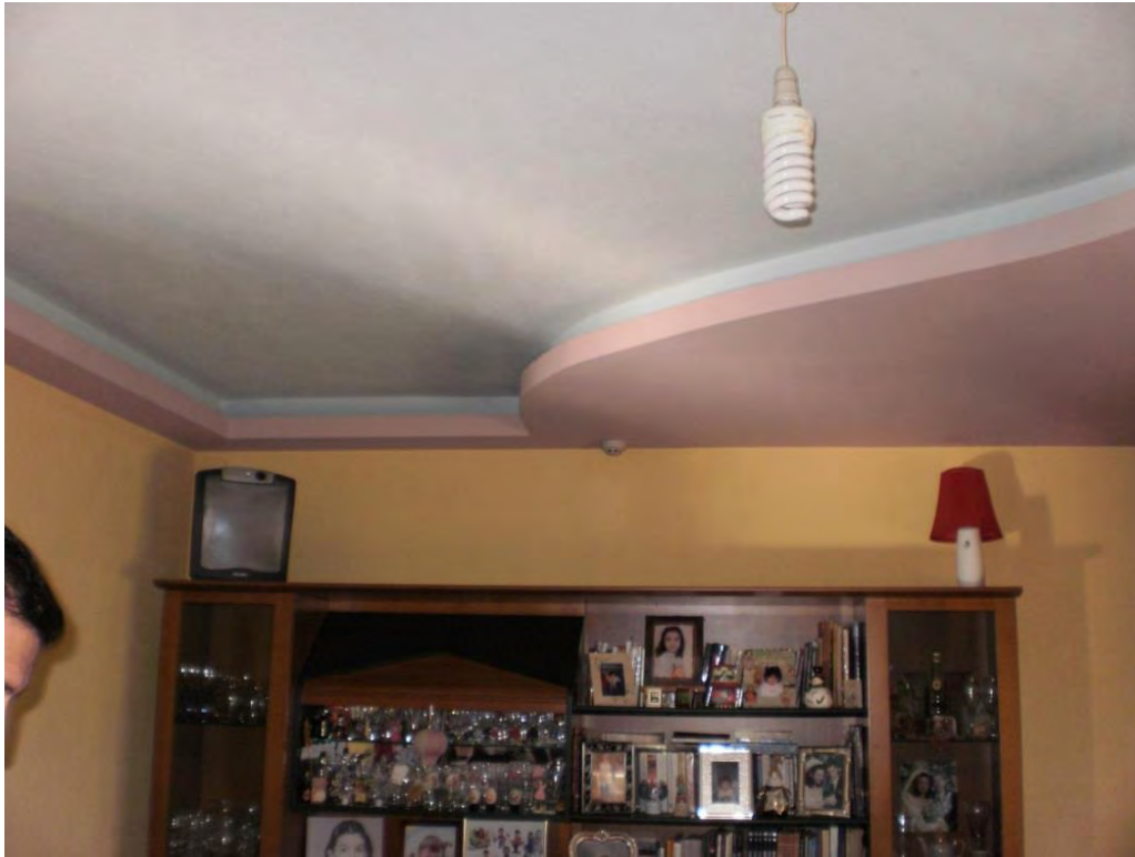
Εικόνα 71: Βορινός τοίχος στο καθιστικό όπου έγινε μέτρηση υγρασίας.
