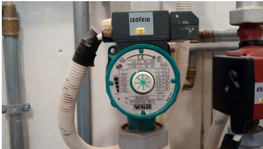
Εικόνα 48: Φωτογραφία της αντλίας του ισογείου.
