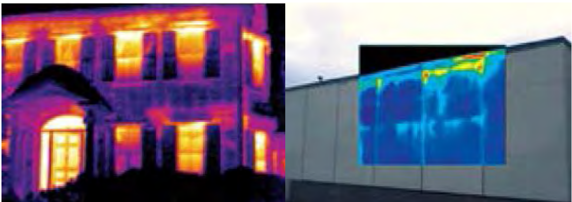
Εικόνα 34: Υπέρυθρες φωτογραφίες κτιρίων από επιθεώρηση. Διακρίνονται οι προβληματικές περιοχές λόγω ελλιπούς μόνωσης.
