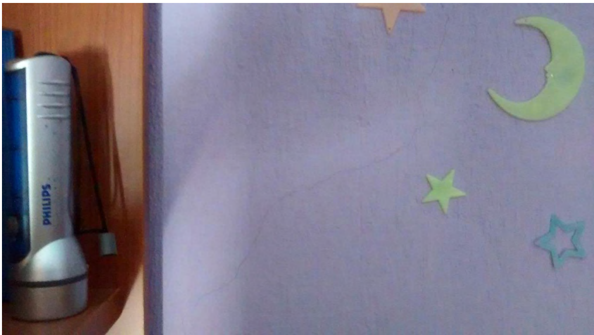
Εικόνα 70: Φωτογραφία του δυτικού τοίχου της παιδικής κρεβατοκάμαρας όπου διακρίνεται μια ρωγμή.
