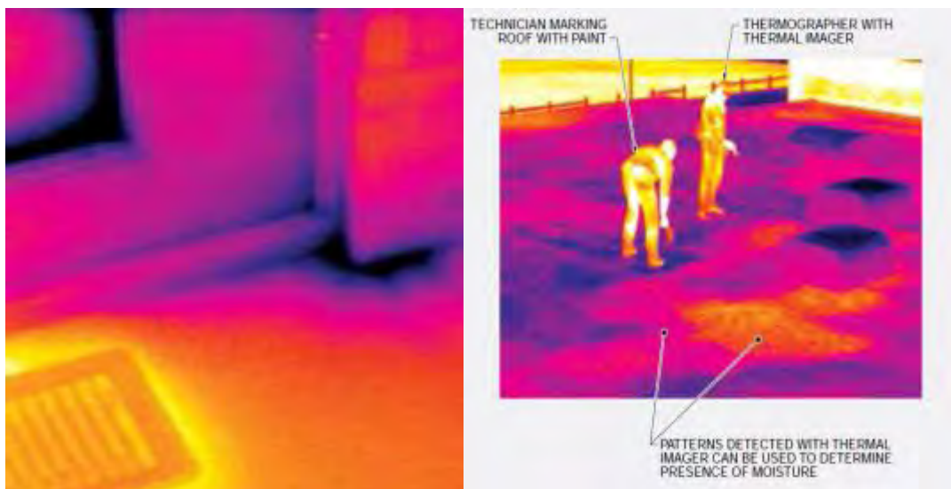
Εικόνα 35: Υπέρυθρες φωτογραφίες κτιρίων από επιθεώρηση. Διακρίνονται οι προβληματικές περιοχές λόγω ελλιπούς στεγανότητας (αριστερά) και λόγω υγρασίας (δεξιά).
