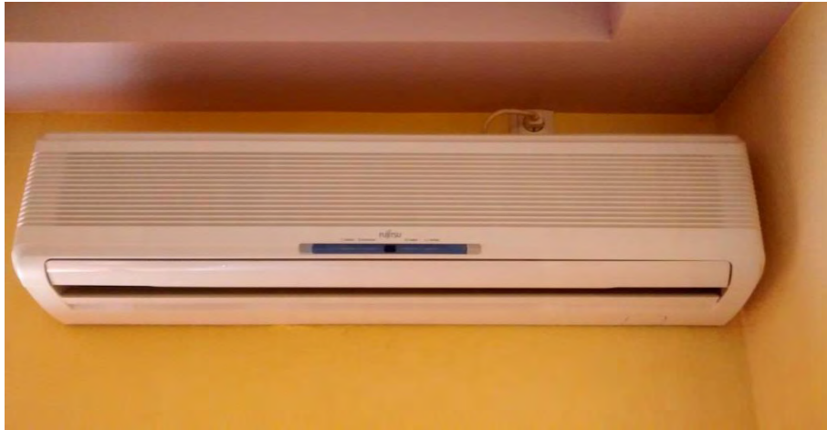
Εικόνα 50: Φωτογραφία εγκατεστημένου στο καθιστικό κλιματιστικού ισχύος 18000Btu.
