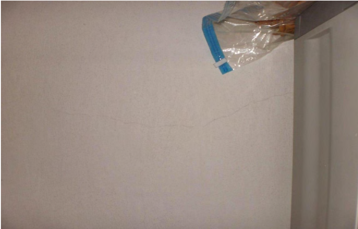
Εικόνα 69: Σημείο λήψης υπέρυθρης φωτογραφίας από τον δυτικό τοίχο του wc του 1 ου ορόφου της οικίας. Διακρίνεται μια ρηγμάτωση στα δεξιά.
