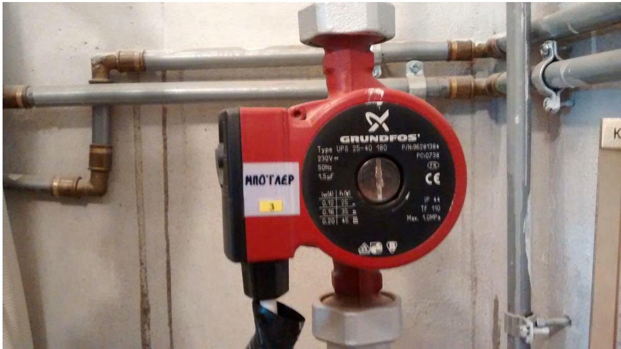
Εικόνα 47: Φωτογραφία της αντλίας του boiler.
