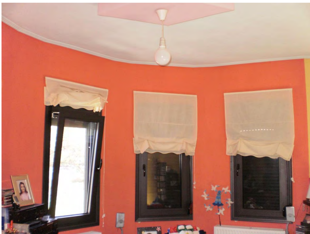
Εικόνα 73: Νότιος τοίχος στο καθιστικό όπου έγινε μέτρηση υγρασίας.
