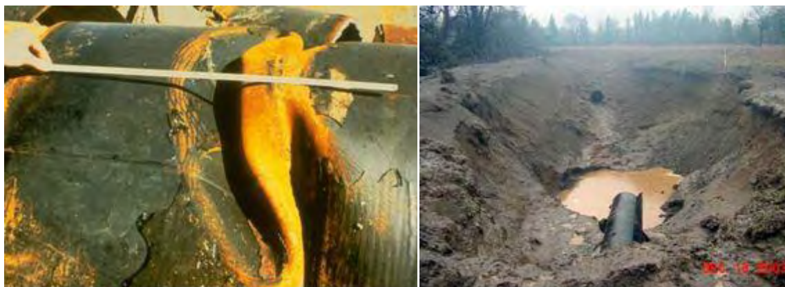
Εικόνα 1.4: Αστοχία αγωγού λόγω κινήσεων του εδάφους (τοπικός λυγισμός και ρωγμή σε αγωγό διαμέτρου 40" και συνέπειες της διάρρηξης αγωγού διαμέτρου 26", USA 2003)
