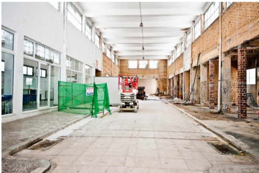
Εικόνα 23: 2015, Το εσωτερικό της Δημοτικής Αγορά Κυψέλης κατά τη διάρκεια των εργασιών αποκατάστασης από το Δήμο
