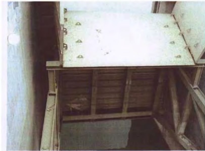
ΦΩΤ.6 ΑΠΟΨΗ ΤΩΝ ΘΥΡΟΦΡΑΓΜΑΤΩΝ ΚΑΙ ΜΗΧΑΝΙΣΜΟΥ ΛΕΙΤΟΥΡΓΙΑΣ
