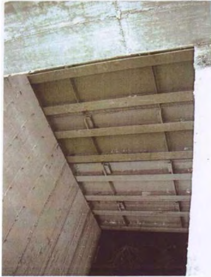
ΦΩΤΟ 14. ΘΥΡΟΦΡΑΓΜΑ ΥΔΡΟΛΗΨΙΑΣ ΑΠΟ ΤΑΜΙΕΥΤΗΡΑ
