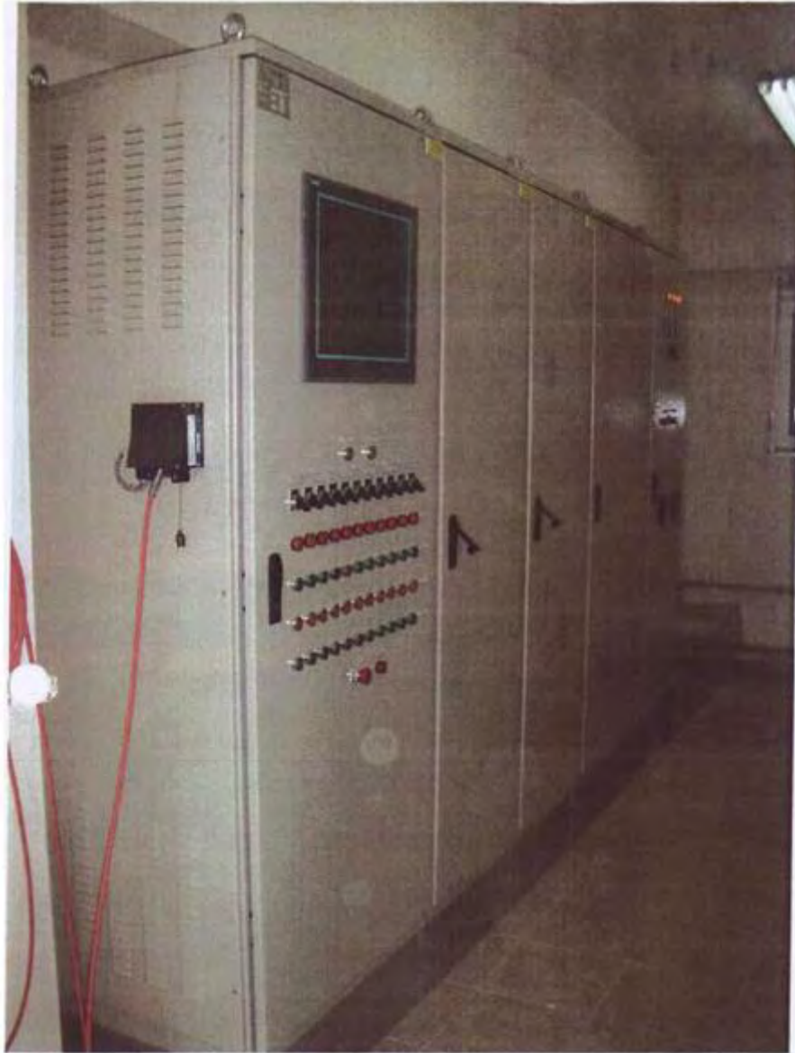
ΦΩΤ.16 ΗΛΕΚΤΡΙΚΟΣ ΠΙΝΑΚΑΣ -ΑΥΤΟΜΑΤΙΣΜΩΝ ΡΟΥΦΡΑΚΤΗ
