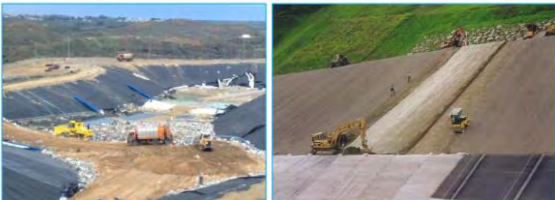
Εικόνα 5: Χώροι Υγειονομικής Ταφής Απορριμμάτων (ΧΥΤΑ), ΠΗΓΗ: (Νταράκας, 2014).
