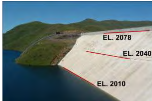
Σχήμα 2 ΡΩΓΜΕΣ ΣΤΗΝ ΠΛΑΚΑ ΤΟΥ ΦΡΑΓΜΑΤΟΣ ΜΟΗΑΛΕ ΜΕΤΑ ΤΗΝ ΠΛΗΡΩΣΗ
