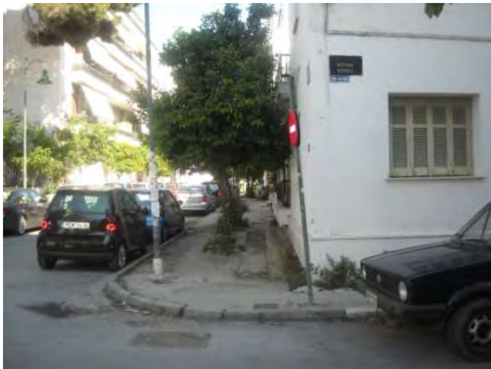
Εικόνα 7.2.12: Κακή ποιότητα επιφάνειας πεζοδρομίου και κρασπέδου στη διάβαση
