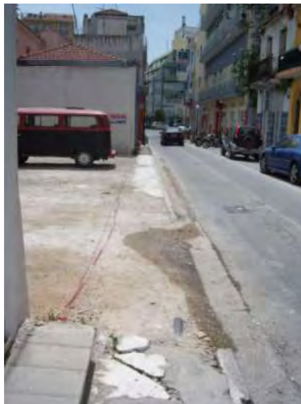
Εικόνα 7.2.8: Ανεπαρκές πλάτος πεζοδρομίου και κακή ποιότητα επιφάνειας πεζοδρομίου
