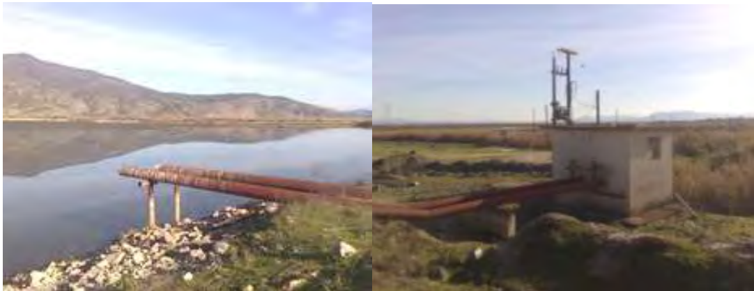
Εικόνα 4: Το αντλιοστάσιο που τροφοδοτεί τους ταμιευτήρες στην περιοχή Ελευθερίου (προσωπικό αρχείο 29/07/2009).
