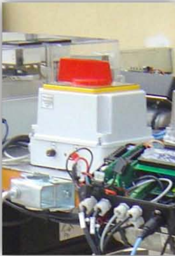
Γενικός διακόπτης ισχύος
