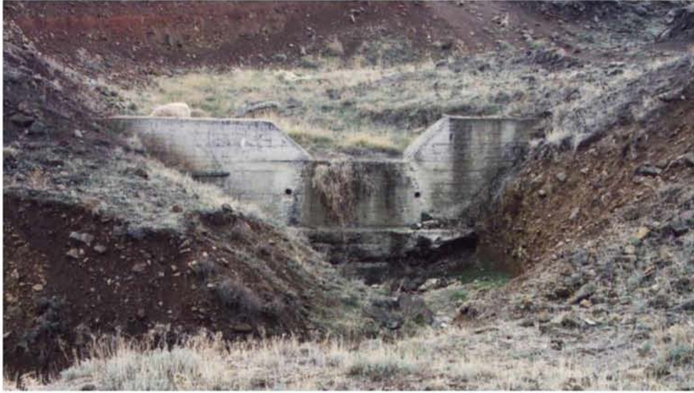
Εικόνα 1.7: Υποσκαφή φράγματος δεξιά στην εικόνα (Μάρης Φ.)
