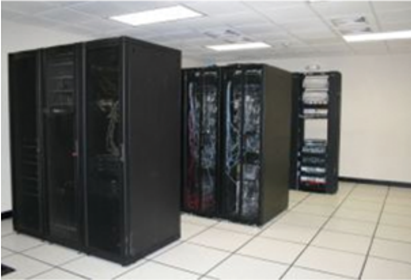
παράδειγμα αίθουσας server εικόνα: http://latashusein.wordpress.com/2011/10/25/membangun-ruang-server-server-room/
