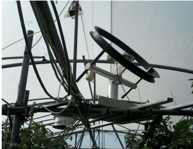
Εικόνα 12. Το δαχτυλίδι σκίασης CM121 εγκατεστημένο στο θερμοκήπιο.
