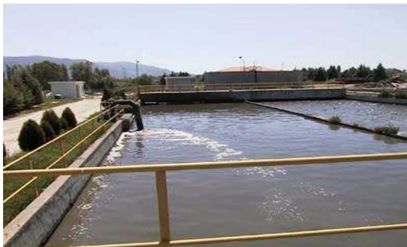
Εικόνα 1.3 : Μονάδα δευτεροβάθμιου βιολογικού καθαρισμού των λυμάτων της Καστοριάς.
