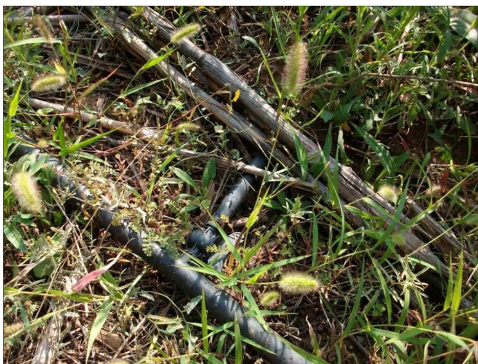
Εικόνα 7. Υπόγεια στάγδην άρδευση
