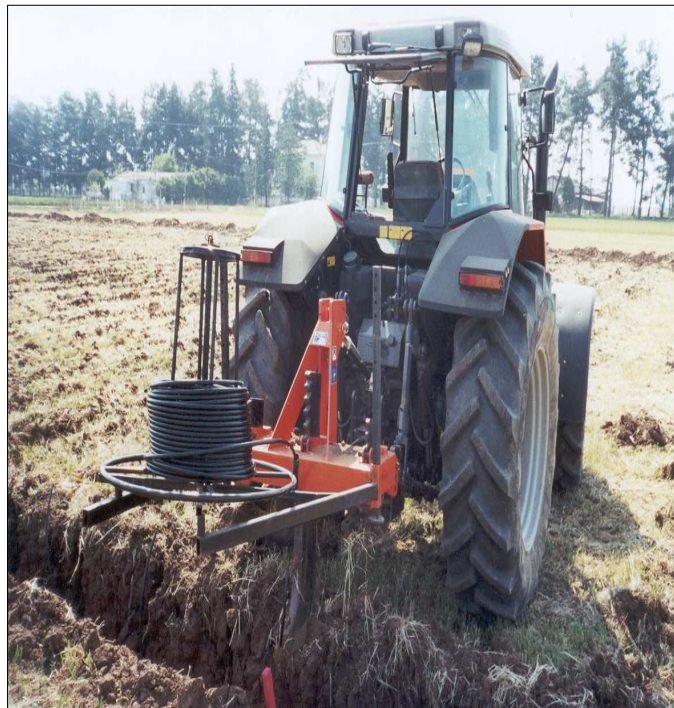
Εικόνα 9. Υπεδαφοθέτης υπόγειας στάγδην άρδευσης.
