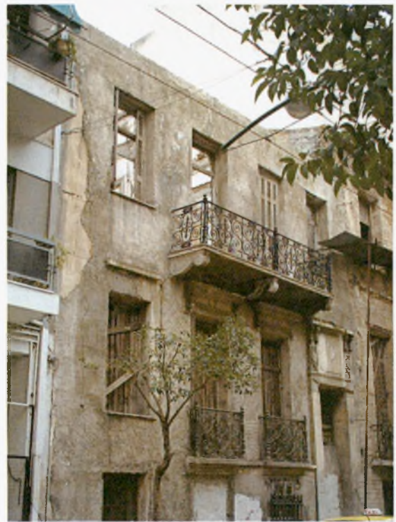
Φωτογραφία 14. Κατοικία σε κακή κατάσταση και εγκαταλειμμένη.
