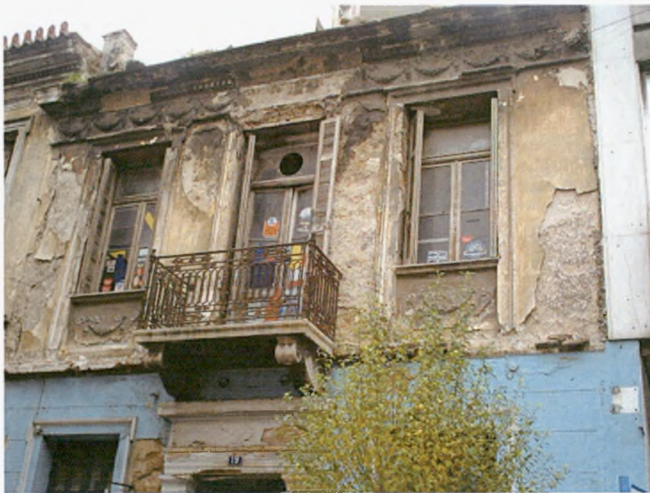
Φωτογραφία 10. Κατοικία σε κακή κατάσταση.
