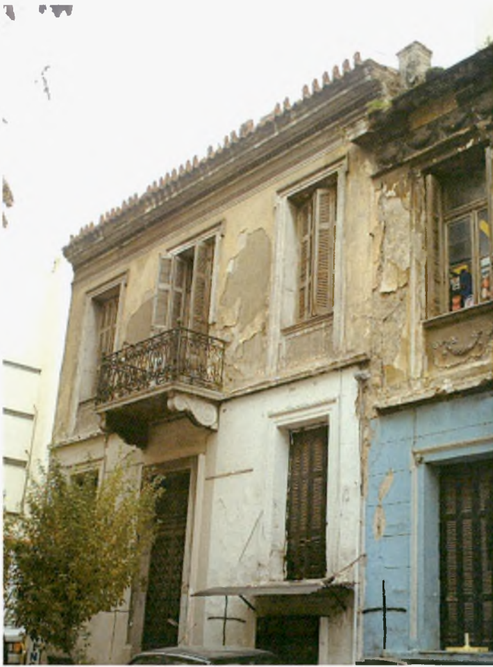
Φωτογραφία 9. Νεοκλασική κατοικία σε κακή κατάσταση.
