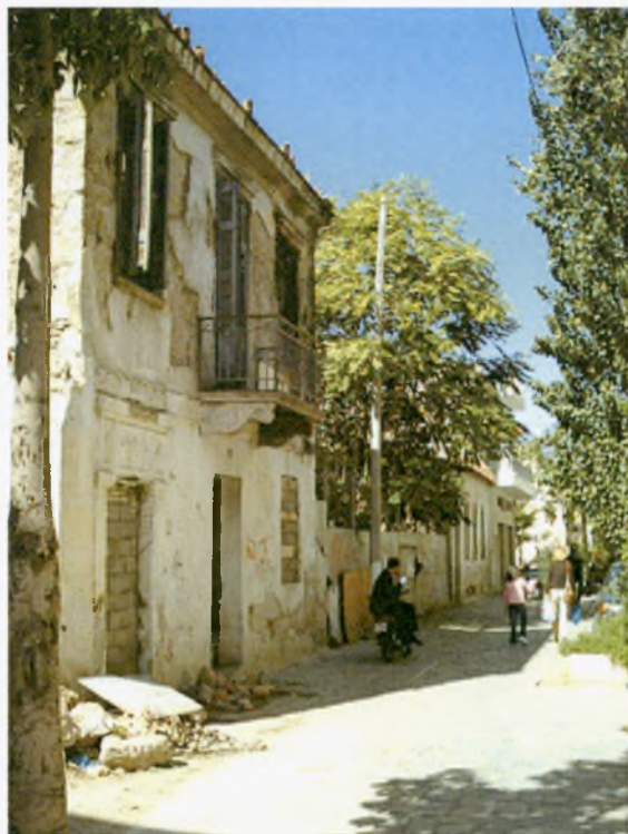
Φωτογραφία 19. Κατοικία σε κακή κατάσταση και εγκαταλειμμένη.
