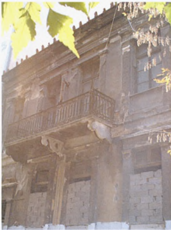
Φωτογραφία 13. Κατοικία σε κακή κατάσταση και εγκαταλειμμένη.
