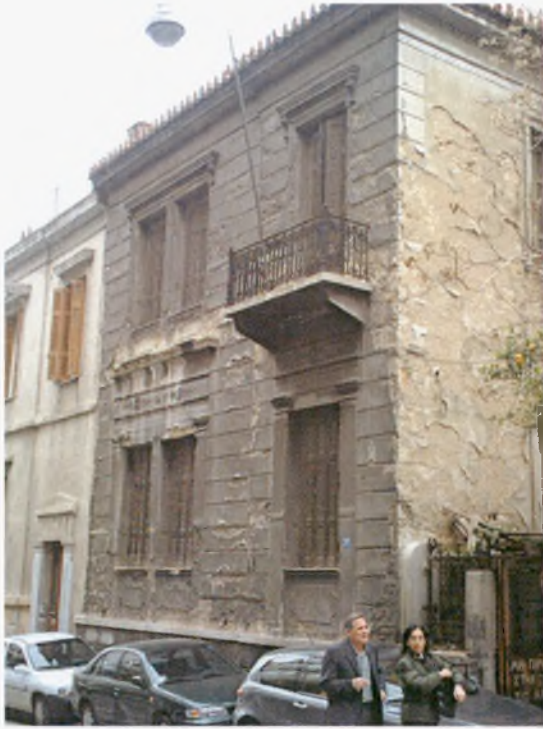
Φωτογραφία 11. Νεοκλασική κατοικία σε κακή κατάσταση.
