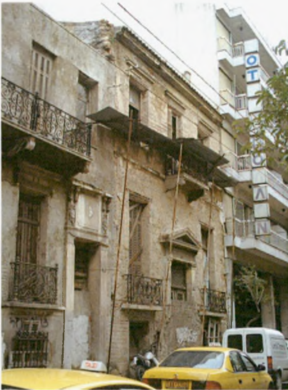
Φωτογραφία 15. Νεοκλασική κατοικία σε κακή κατάσταση και εγκαταλειμμένη.
