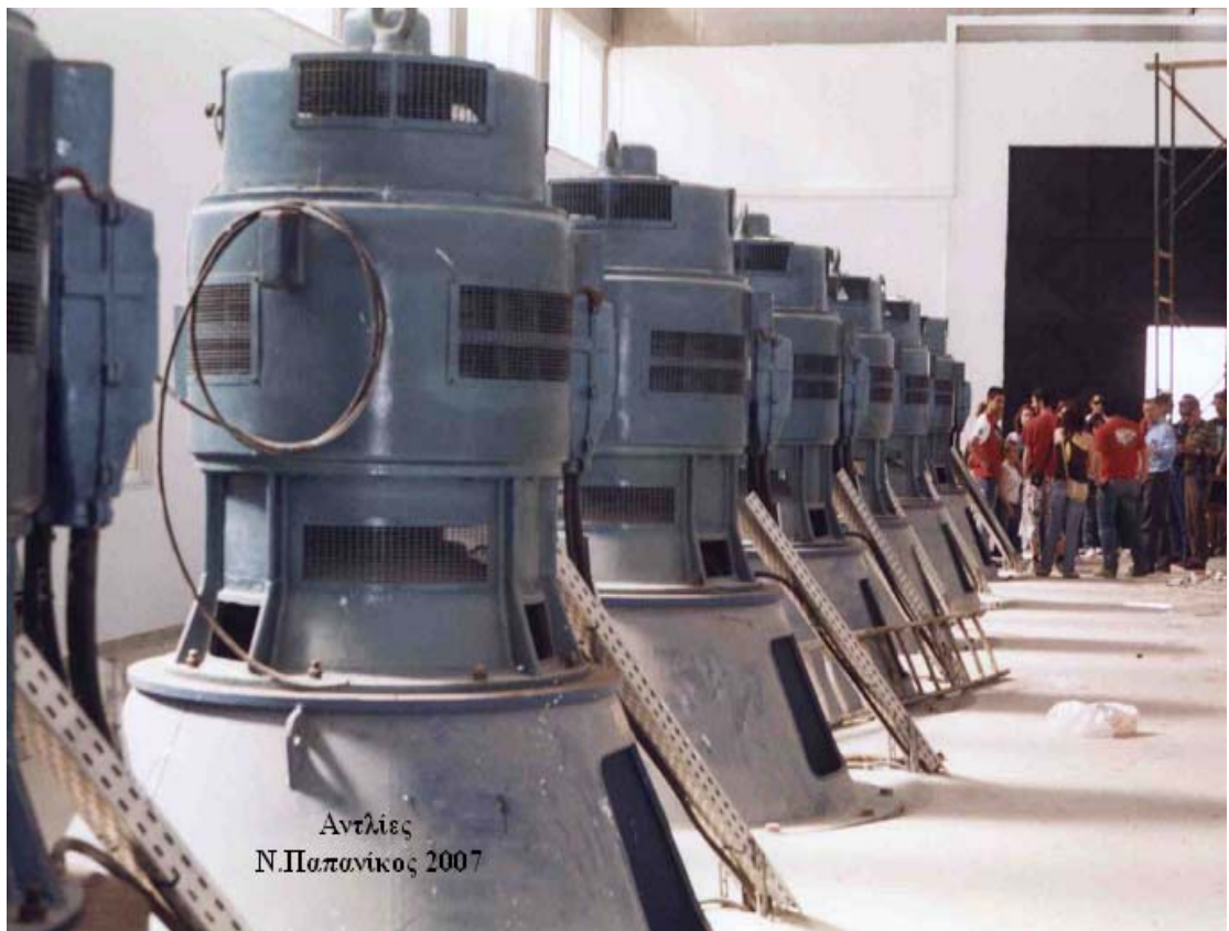
Εικόνα 70. Αντλίες στα Αντλιοστάσια Κόμβου Πέτρας
