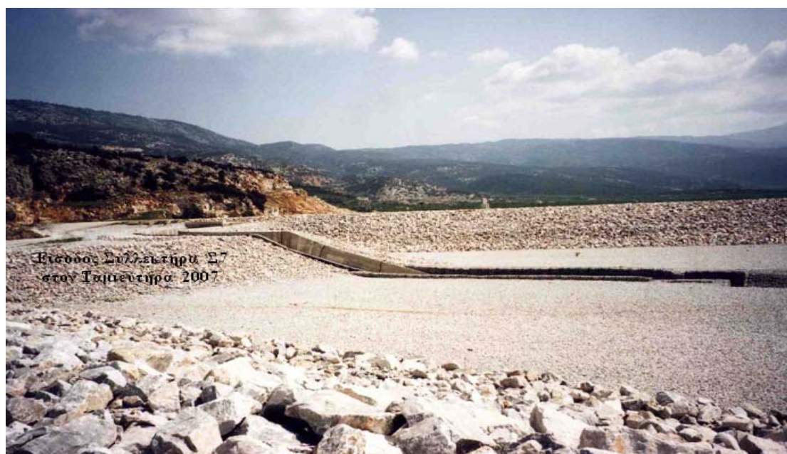
Εικόνα 80. Συλλεκτήρας Σ7 εσωτερική πλευρά
