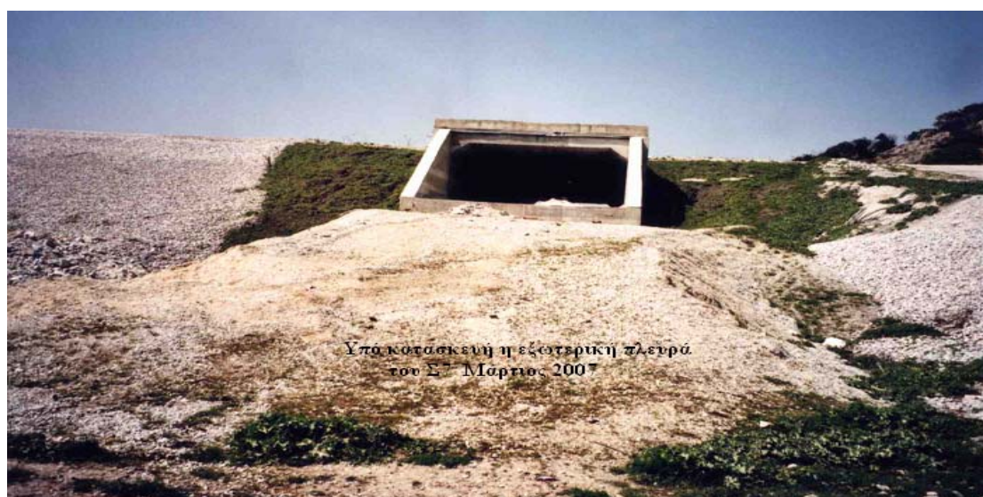
Εικόνα 81. Συλλεκτήρας Σ7 εξωτερική πλευρά.
