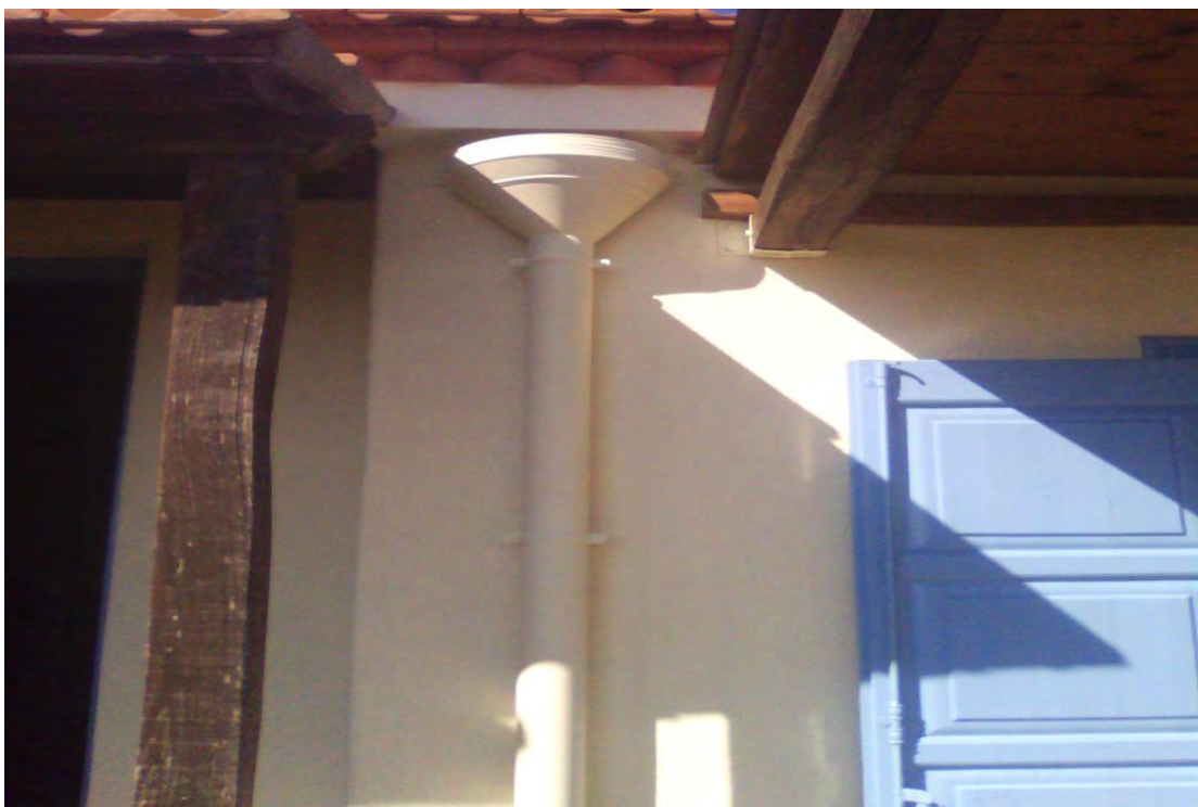
Εικόνα 2 : Σύστημα συλλογής βρόχινου νερού σε οικία στην Αλόνησο
