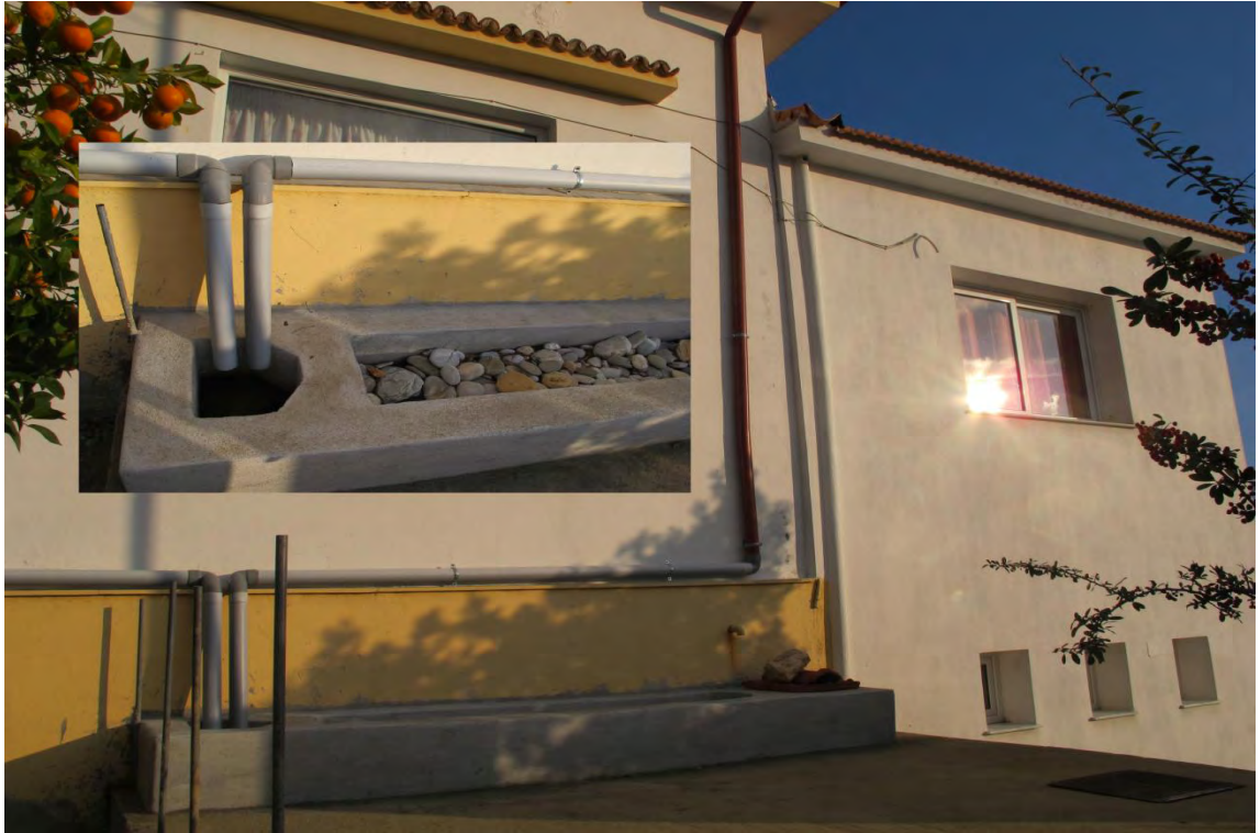
Εικόνα 4 : Δίκτυο ομβριοσυλλογής και προεπεξεργασίας του νερού πριν να εισέλθει στην δεξαμενή αποθήκευσης σε κτίριο στο Πατητήρι Αλόνησου.
