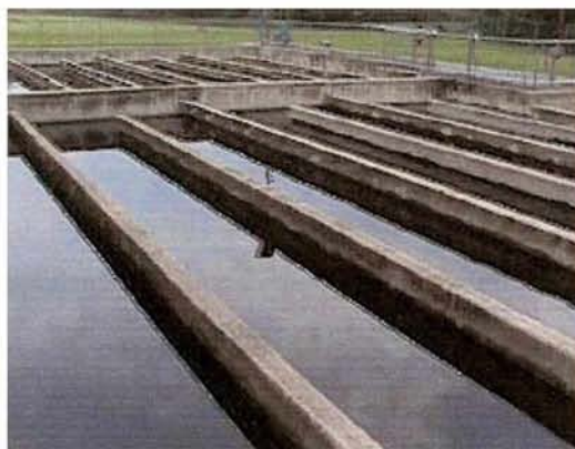
Εικόνα 4.7.1.5.1. Δεξαμενές απολύμανσης (Ράμμος Ι., 2006).
