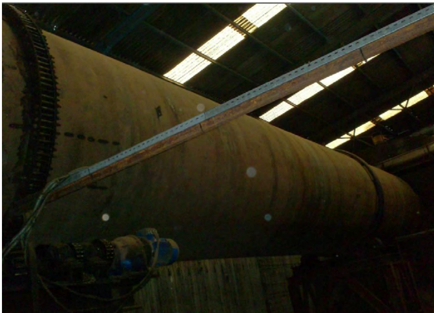
Εικόνα 2.5: Ξηραντήριο ελαιοπυρήνων – Περιστρεφόμενο τύμπανο (ΕΛΚΕ Α.Ε. Greece 2010)
