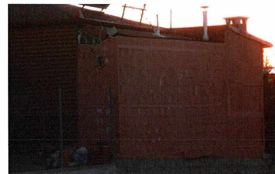
Εικόνα 72 Επέκταση Προσκολλημένη Δίπλα σε Αυθαίρετη Κατασκευή
