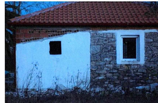
Εικόνα 75 Έντονη Χωρική Επέκταση Αυθαίρετου Σπιτιού Δίπλα στο Υφιστάμενο Αυθαίρετο
