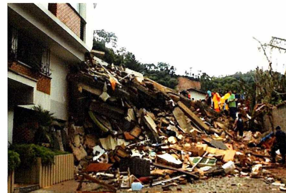
Εικόνα 39 Κατάρρευση Αυθαίρετης Κατασκευής μετά από σεισμό_ Αναμφίβολη ποιότητα υλικών και απουσία μελέτης
