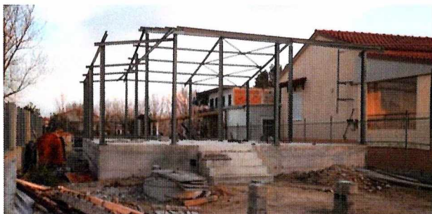
Εικόνα 82 Φέρωντας Οργανισμός Αυθαίρετης Κατασκευής
