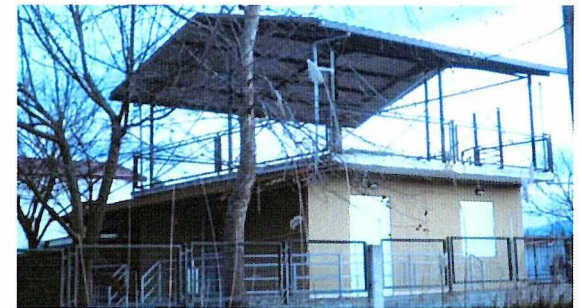
Εικόνα 70 «Εν Δυνάμει» Κάθετη Επέκταση _Αυθαιρέτο Στέγαστρο
