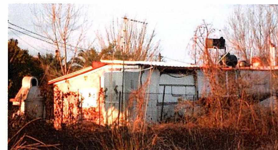
Εικόνα 61 Αυθαίρετη Κατασκευή Στεγασμένου Χώρου Δίπλα σε Τροχόσπιτο με Ενιαία Στέγη
